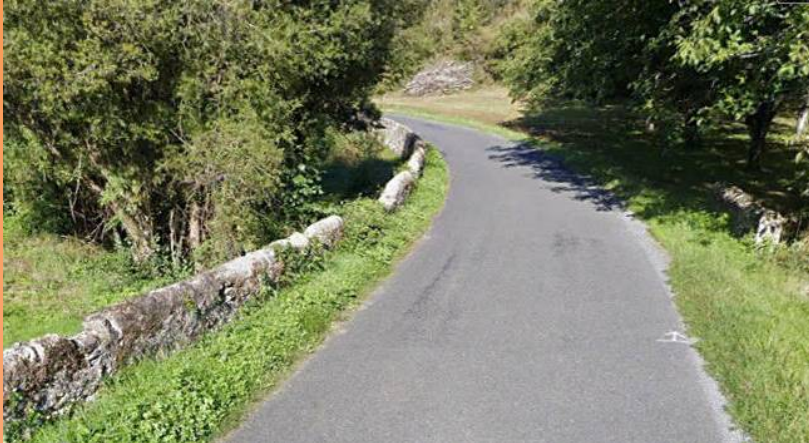
Avant : Pont de soutènement dont la vétusté est visible avant les travaux.
